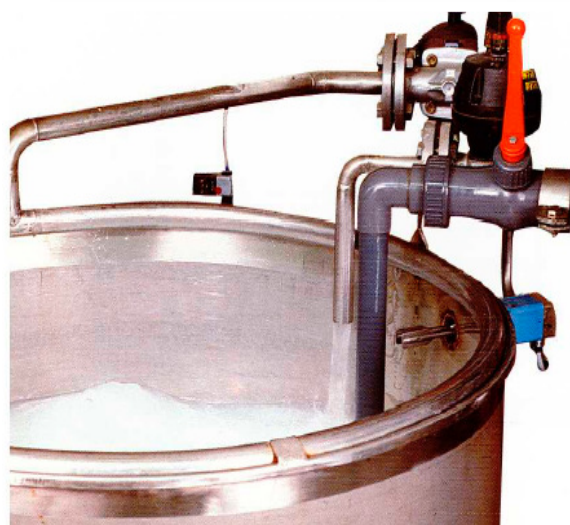
Grenzstandüberwachung mit Liquiphant-Sonden an einem Ansetzbehälter mit Rührwerk. Zuverlässige Funktion auch bei wechselnden Flüssigkeiten, unempfindlich gegen Turbulenzen, Strömungen und Schaum.
