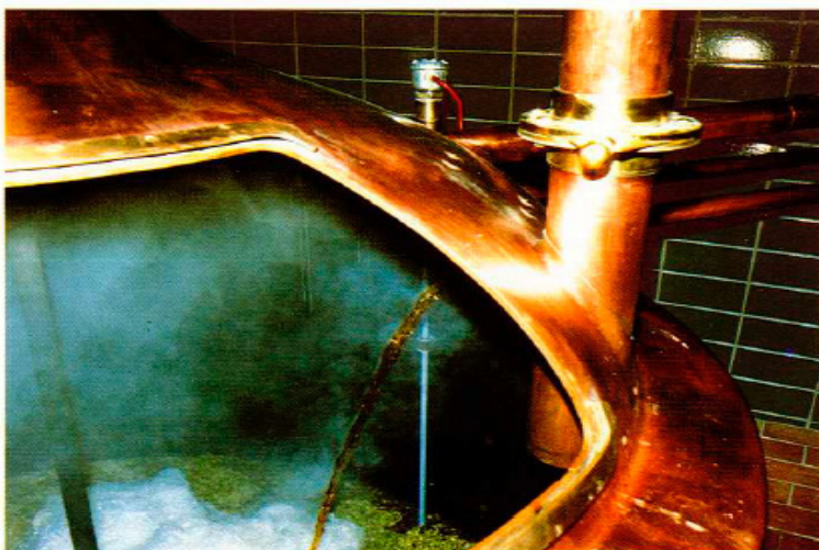
Kontinuierliche Füllstand-Überwachung mit kapazitiver Sonde in der Sudpfanne einer Brauerei
